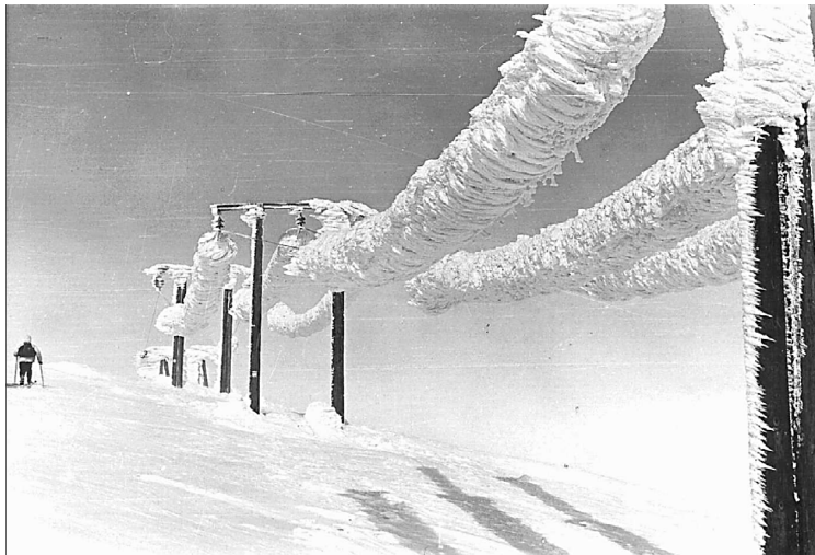
Обледенение линий электропередач (Roots и Makkonen 2000)
